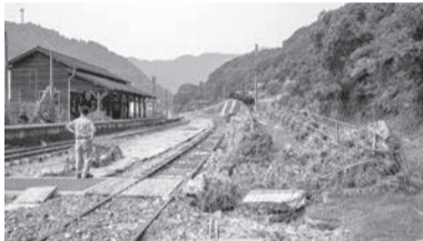
令和2年7月豪雨による肥薩線の被害状況を視察
